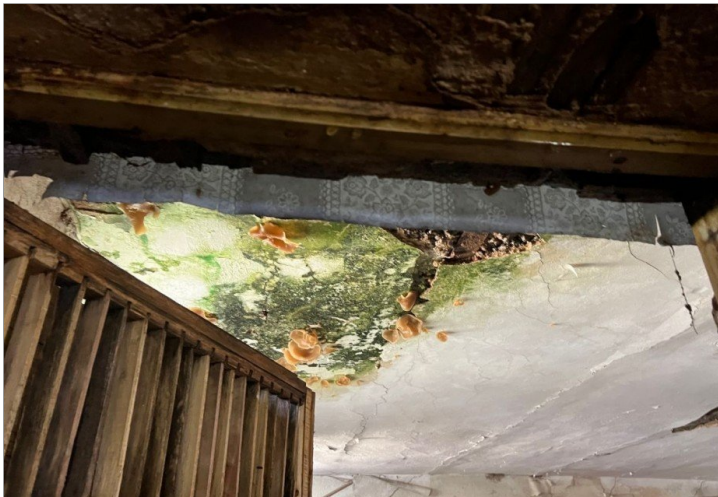
Massiver Schimmel + Pilzbefall
